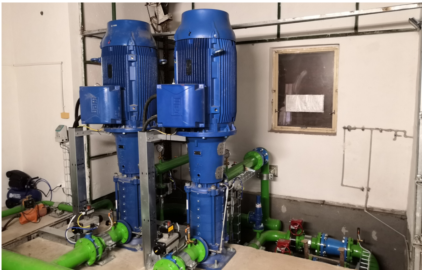
Nová čerpací stanice zasněžování (sever)
